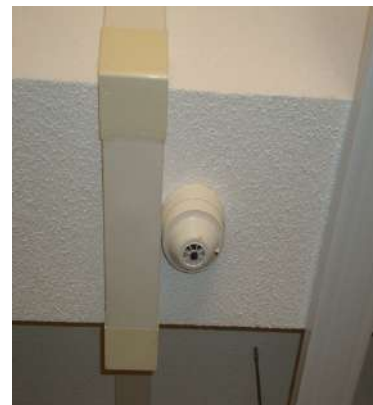
DETECCIÓN DE HUMOS CONTRA INCENDIO
