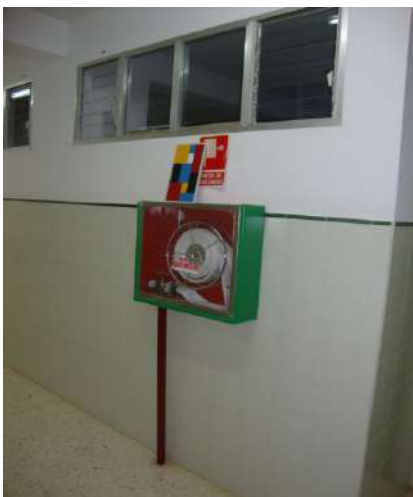
BOCA DE INCENDIO P1
