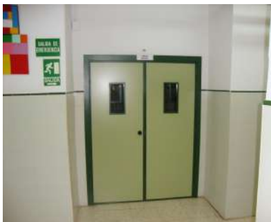
SEÑALIZACIÓN RECORRIDO EVACUACIÓN A SALIDA SE-1 Y SE-4
