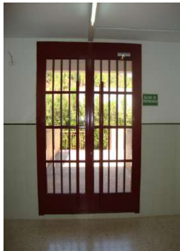
SALIDA EMERGENCIA P1 SE-5
