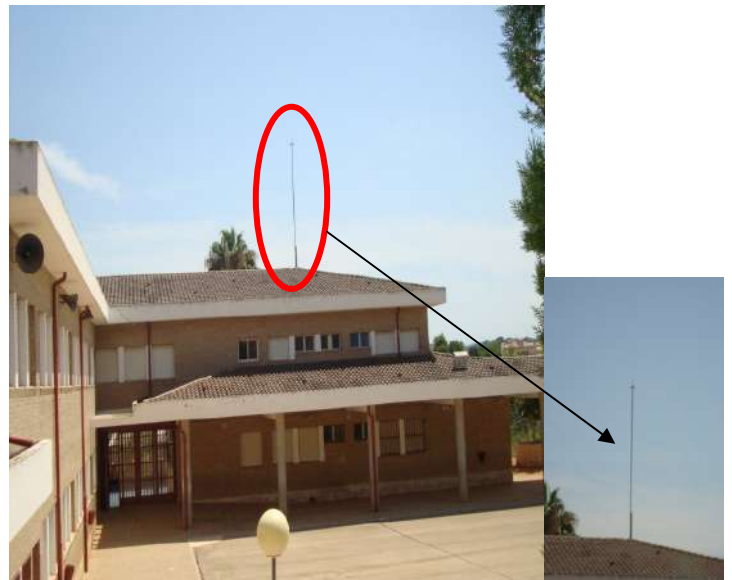
INSTALACIÓN PARA- RAYO
