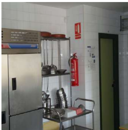
EXTINTOR EN LOCAL RIESGO ESPECIAL
