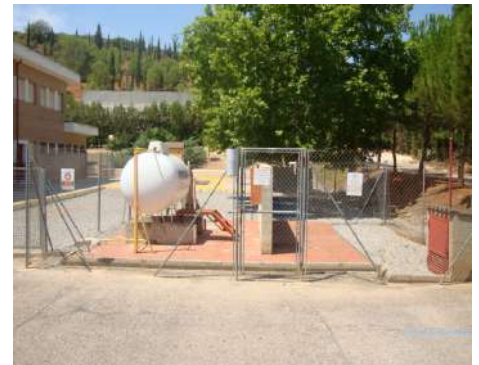
DEPOSITO DE GASOIL Y BUTANO SEPARADO POR MURO DIVISOR Y CERRADOS PERIMETRALMENTE (CUMPLE)
