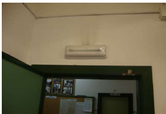
SISTEMA ALUMBRADO EMERGENCIA EN PARTE SUPERIOR PUERTAS DEPENDENCIAS
