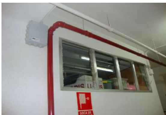
INSTALACIÓN DE AGUA VISTA CONTRA - INCENDIO
